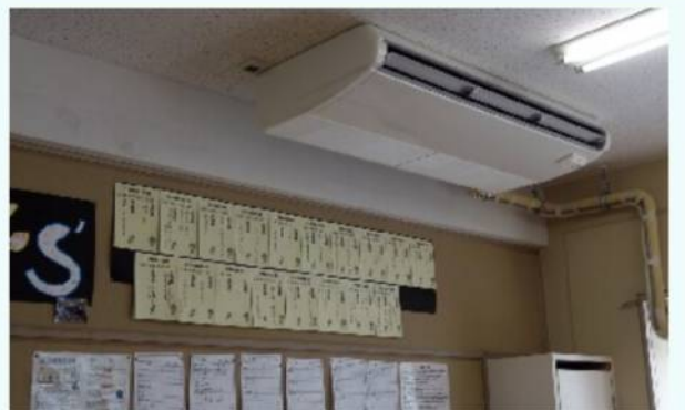
白子中学校普通教室に設置されたエアコン
