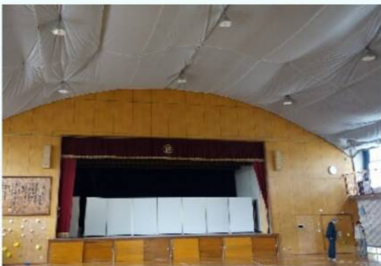
天井からの落下物危険防止ネットが張られた体育館(河曲小学校)
